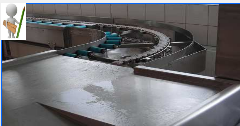
Adaptation sur un virage mécanisé existant.
